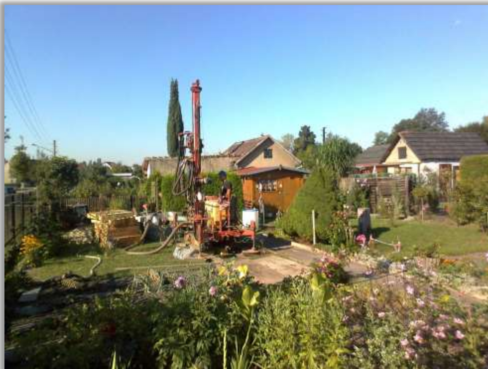
Bohrerkundung nach einem Tagesbruch in einem ehemaligen Braunkohlenabbau Feld in der Stadt Meuselwitz
