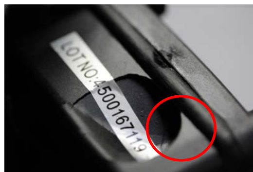
Bild 13 Der Schutz gegenüber Spritzwasser nach IP 44 ist nicht mehr gegeben.
