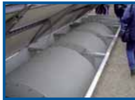
Scheibentauchtropfkörper-Anlage Quelle: TMLNU
