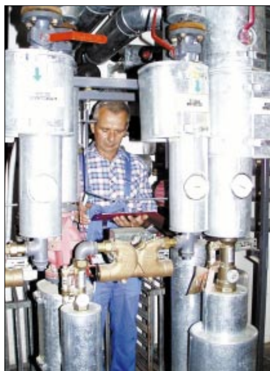
Abb. 11: Ablesen der Verbrauchswerte Fernwärme
