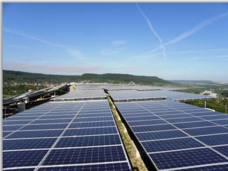
Detailansicht der Fotovoltaikanlage auf der Halde Bleicherode
